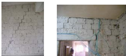
Fig. 5, 6 Aspect fisuri în pereți interiori
