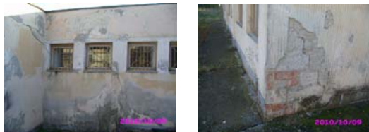
Fig. 3, 4 Aspect fisuri înclinate perete ax 1' și ax 1
